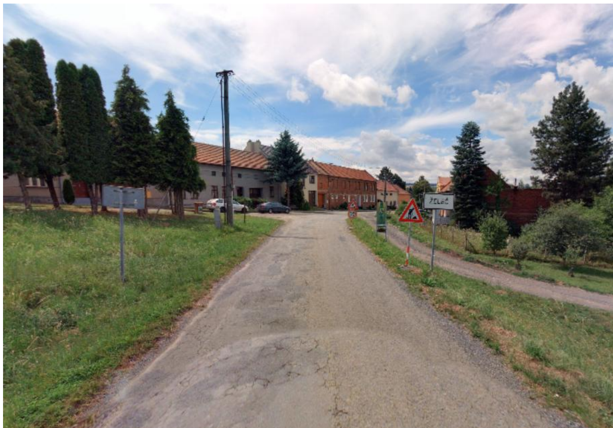
Obrázek 2: Ukázka stavu silnice 43310 na okraji obce
